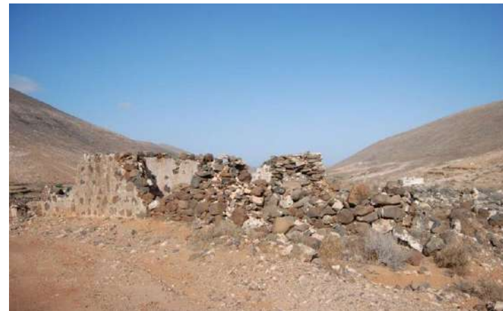
Fig 61. Estado del inmueble en los Estudios Previos de 2019
