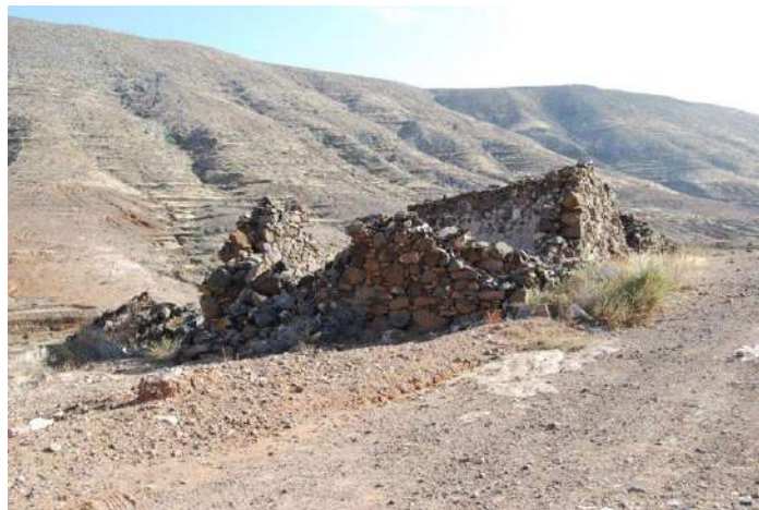
Fig 63. Estado del inmueble en los Estudios Previos de 2019
