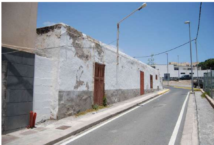
Fig 75. Estado del inmueble en los Estudios Previos de 2019
