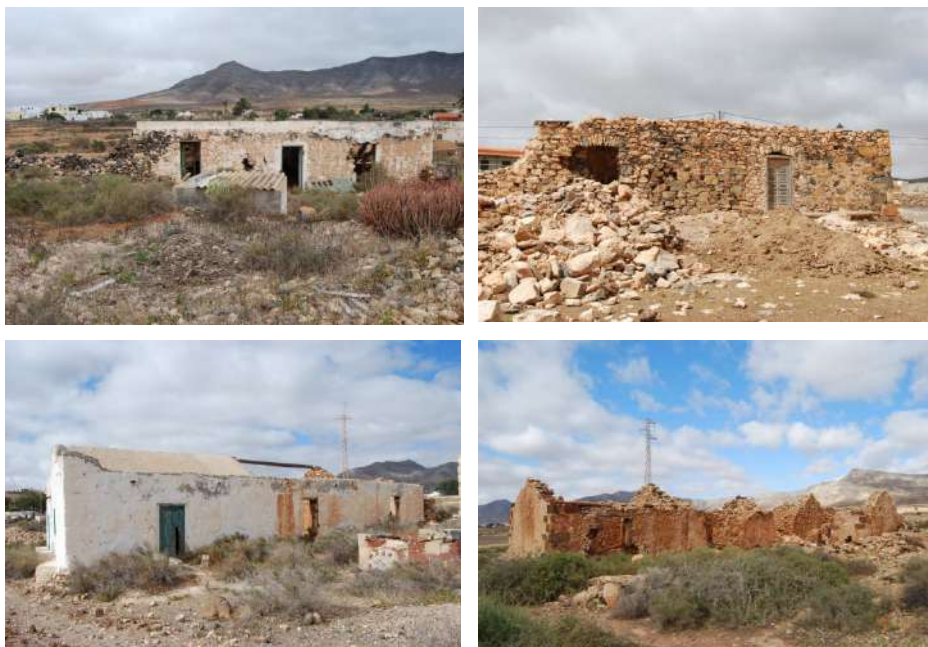
Fig 3. Casas tradicionales en ruina
