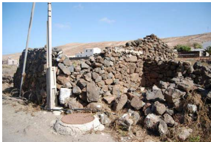
Fig 55. Estado del inmueble en los Estudios Previos de 2019
