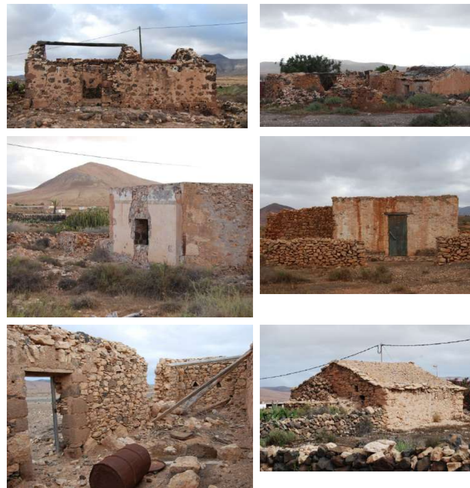
Fig 21. El mal estado de parte del patrimonio del municipio
