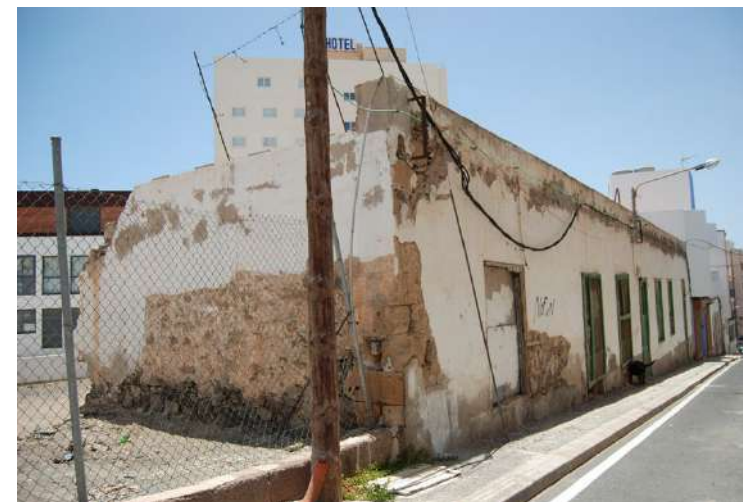
Fig 77. Estado del inmueble en los Estudios Previos de 2019
