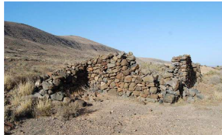
Fig 65. Estado del inmueble en los Estudios Previos de 2019
