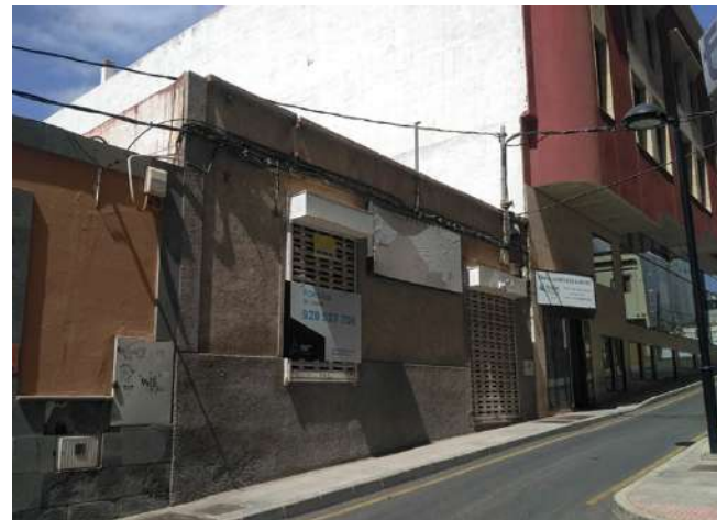
Fig 69. Estado del inmueble en los Estudios Previos de 2019
